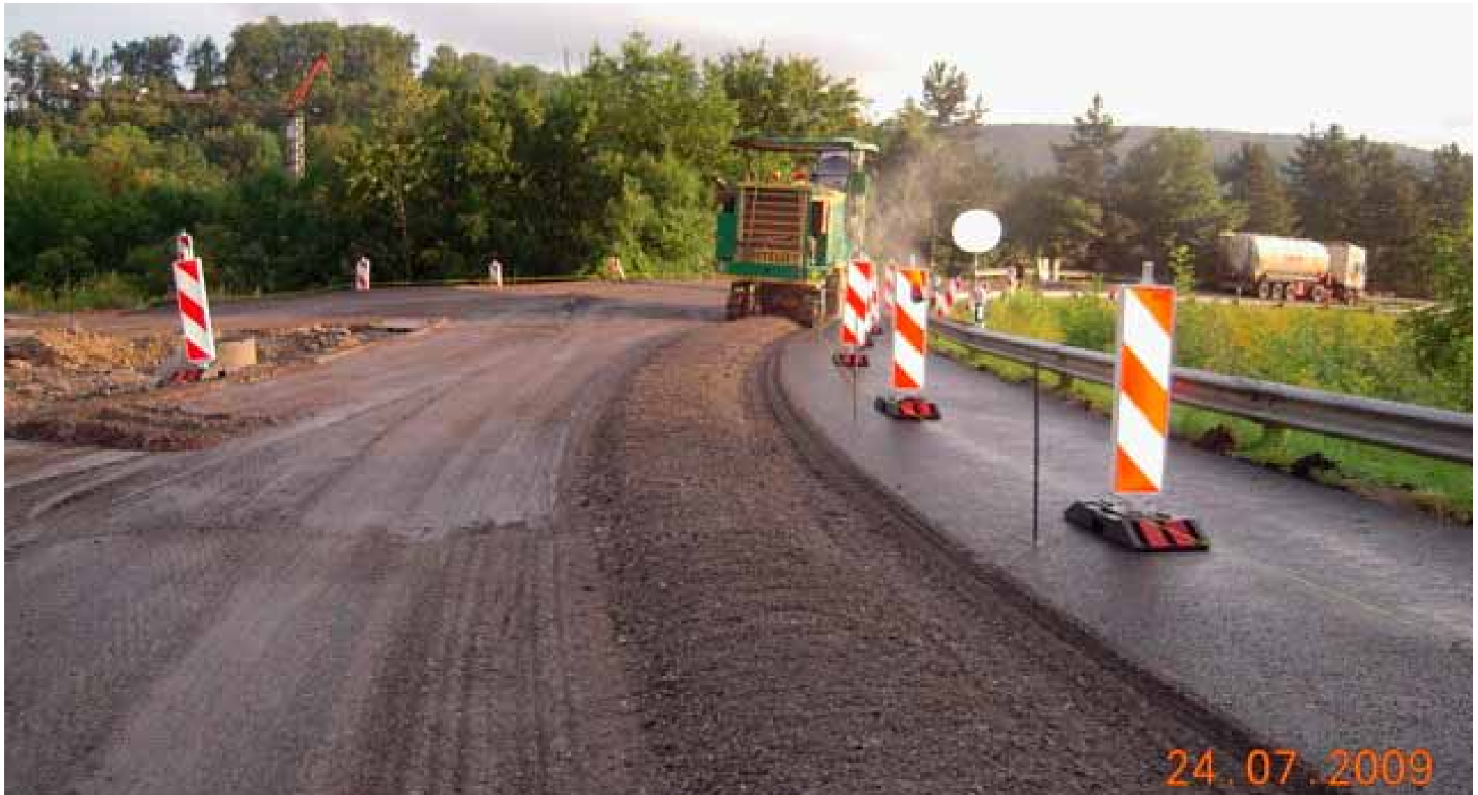
Abfräsen des alten Asphaltbelages (den einen Teil liegen lassen, den restlichen Teil abführen)
